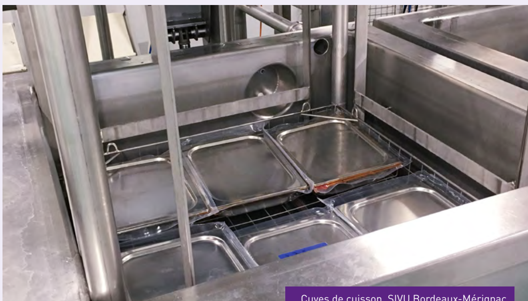
Cuves de cuisson, SIVU Bordeaux-Mérignac
